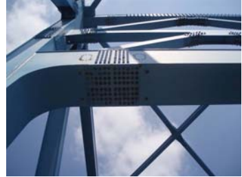
⑦既設部材の腐食状況
