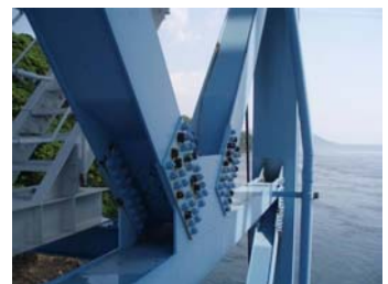
⑨既設部材の腐食状況
