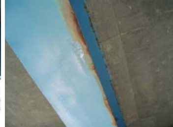
⑥既設部材の腐食状況
