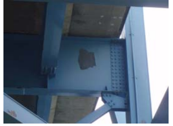
④既設塗装の剥離状況
