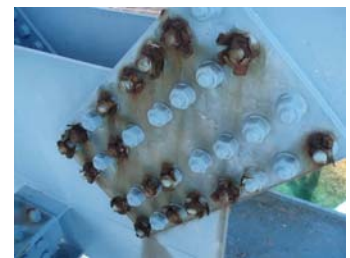
⑩既設部材の腐食状況
