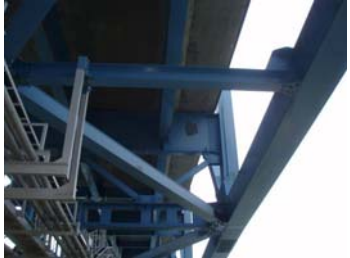
③既設塗装の剥離状況
