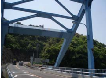
①既設塗装の剥離状況
