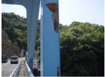
②既設塗装の剥離状況
