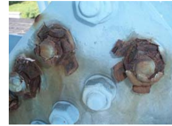
⑪既設部材の腐食状況
