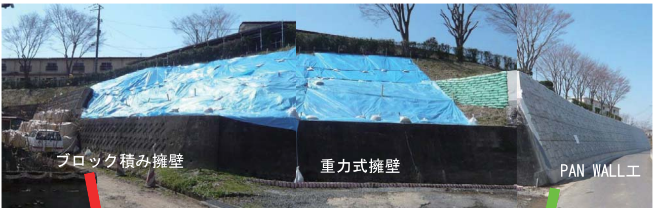
福島県須賀川市内 震度6強 被災した周辺構造物と健全なPW
