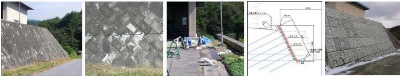
写真-3 被災状況
