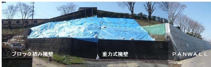
写真-1 被災した周辺構造物（左側と中央）と健全な PAN WALL（右側）
