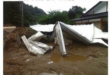
肝付町北方地内 土石流被害状況
