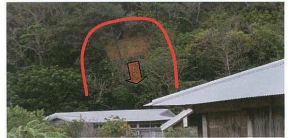
大島郡瀬戸内町三浦地区(がけ崩れ)
