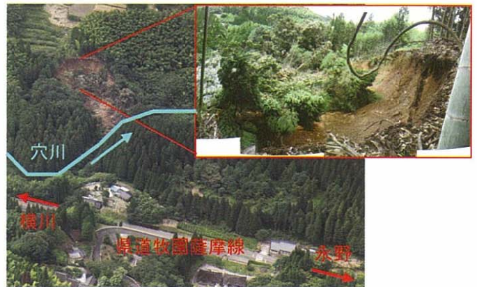
さつま町鉱事場地区 地すべり
